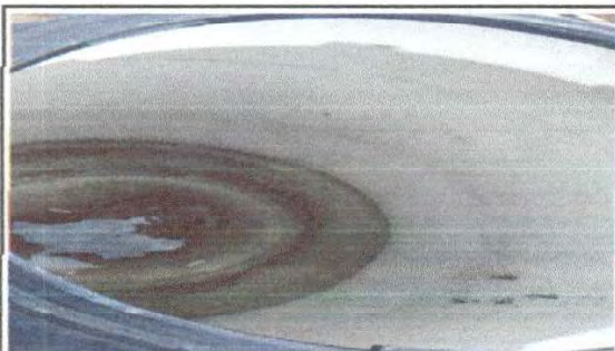
Foto 3: el tinaco ya presenta problemas de deterioro.
