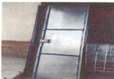
Foto 3: Puertas soldadas con chapa falta pintura.
