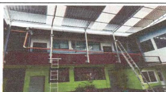
Foto 4: distancia en que fueron colocados dos lamparas tipo reflectores led para alumbrar el patio lado derecho.
