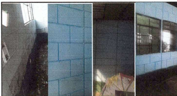
LAS AULAS DE CONCRETO LLEVARON MAS PINTURA DE LO ESTIPULADO
