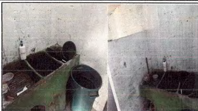
Foto 2: Area del baño que necesita dos labamanos y piso porcelanato. La pila ya no sirve.
