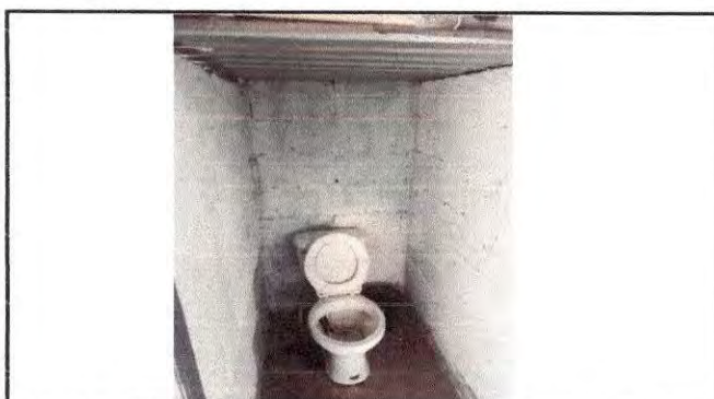
Foto 4: Area de baños de los jovenes que se necesita pila de un solo lavadero y un labamanos y piso de porcelanato.
