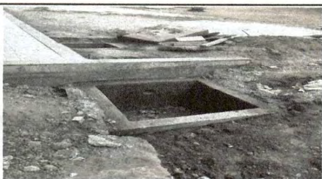
Foto 3: Caja de agua para el agua pluvial
