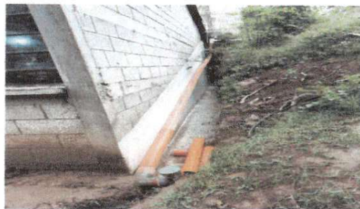
Foto 2: Repello de pared dañada por la humedad.
