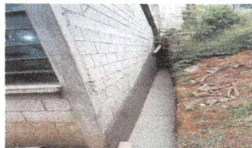
Foto 2: Repello de pared dañada por la humedad.
