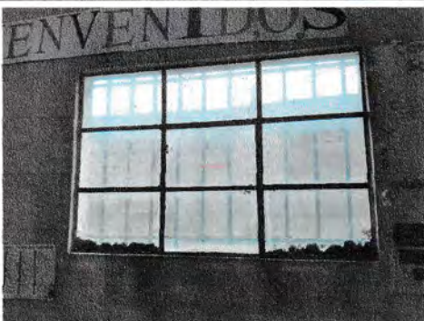
Foto 11: Ventana a sustituir, se encuentra sellada
