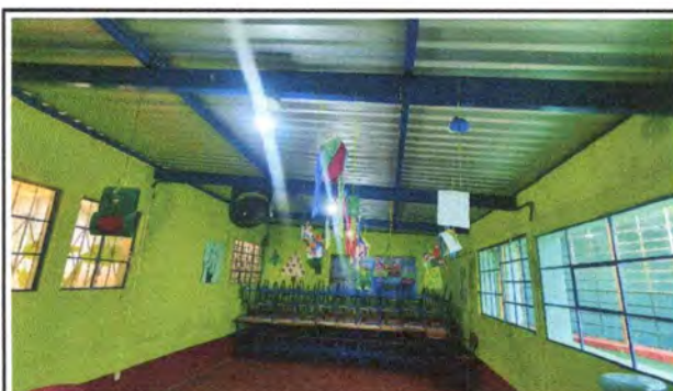
Foto 12: Iluminacion de interiores de aula
