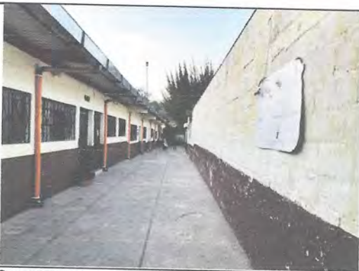
Foto 4: Se muestran las aulas conectadas al mismo circuito, por lo que se disparan los flipones por falta de circuitos y al tener todo encendido se sobrecargan las líneas, la jornada no se tiene acceso al tablero.
