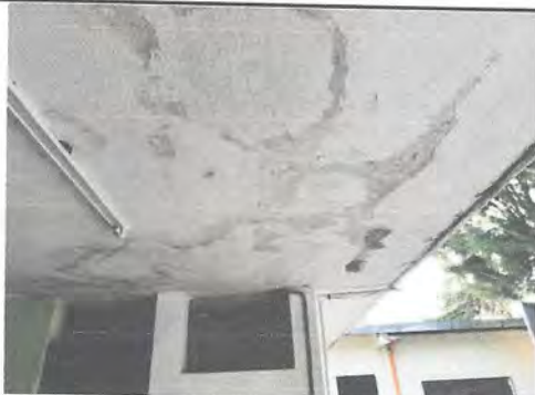
Foto 6: Desprendimiento de pintura en cielo y muros, los problemas de humedad que generaron dicho problema han sido reparados por los padres de familia.
