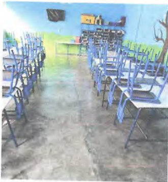
Foto 10: Piso de concreto, que presenta grietas.
