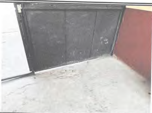
Foto 2: Portón con problemas de óxido en la parte inferior, por lo que deberá sustituirse, aplicar pintura anticorrosiva.
