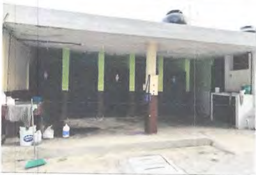
Foto 5: Batería de baños sin piso.
