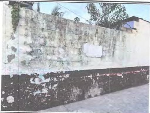
Foto1: . Se muestra el estado en el que se encuentra el muro colindante, propiedad del vecino
