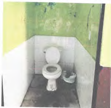
Foto 7: . Inodoros quebrados y en mal estado.
