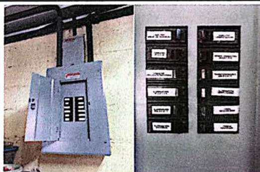
Foto 4: Tablero de distribución + caja de protección RH.
