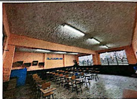
Foto 2: Instalación eléctrica de iluminación en módulo A
