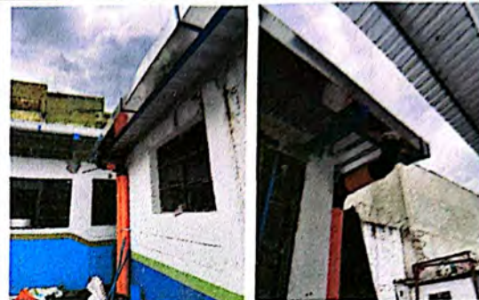
Foto 8: Canal y tubería para la descarga pluvial en área de cocina.
