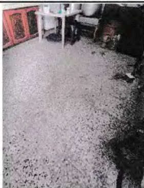
Foto 3: Piso de cocina en mal estado.
