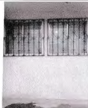
Foto 10: Balcones con pintura en mal estado.
