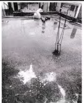
Foto 6: Terraza sin pañuelos, agua empozada.
