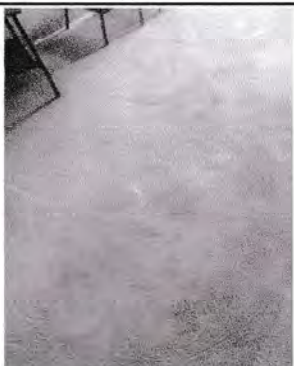
Foto 4: Torta de concreto en bodega, sin piso.
