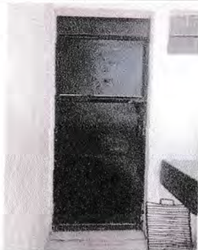
Foto 9: Puertas con pintura en mal estado.
