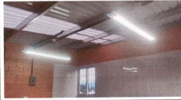
INSTALACION DE ELECTRICIDAD FUERZA E ILUMINACIÓN
