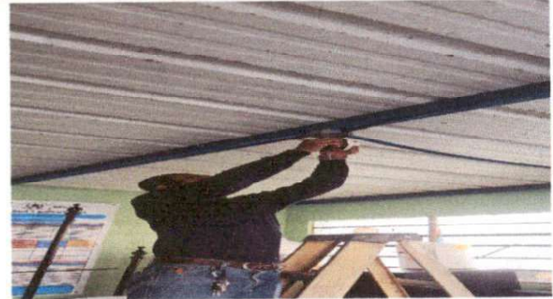
INSTALACION DE ELECTRICIDAD FUERZA E ILUMINACIÓN
