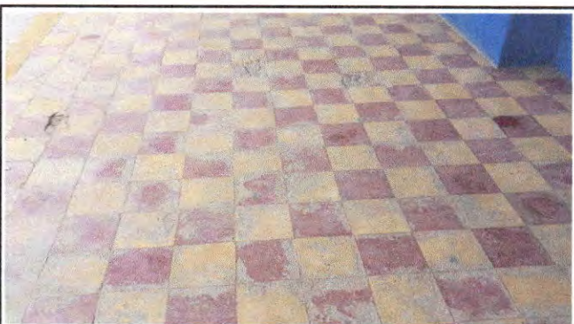
Foto 11: Fotografía de piso en mal estado
