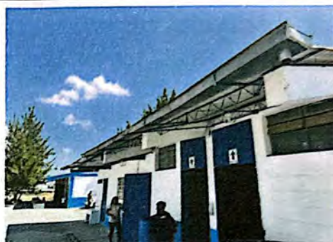
Foto 8: Módulo B, los canales pluviales se encuentran fuera de servicio y no se cuenta con bajadas pluviales.
