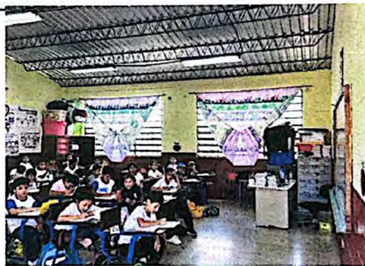
Foto 4: Salón de clases con problemas de ventilación
