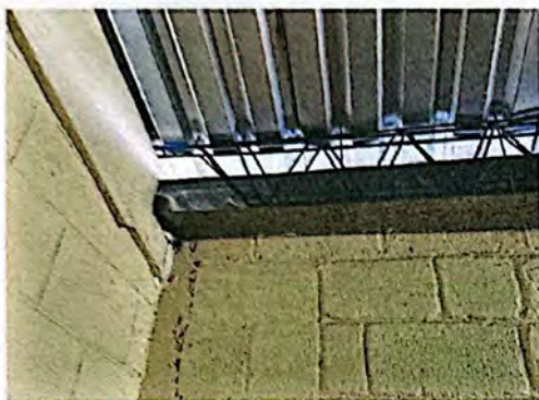
Foto 7: Canal pluvial que presenta problemas de filtración.
