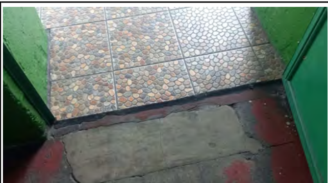
Foto 9: Piso en mal estado
