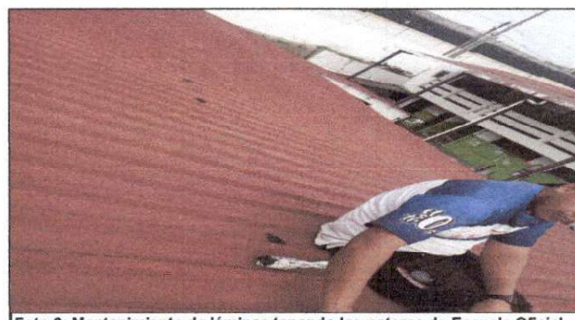
Foto 6: Mantenimiento de láminas tapando las goteras de Escuela Oficial Urbana Mixta No. 34 "20 de Octubre" J.V.
