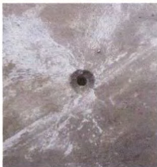
Foto 1: Sellar reposadera que causa inundación dentro de la cocina.
