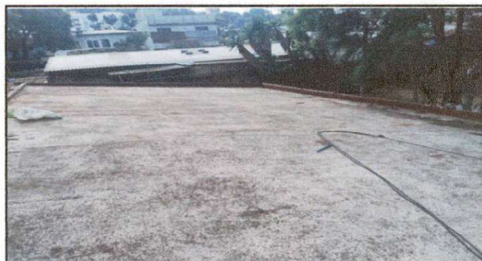
Imagen de danos en losa modulo 2
