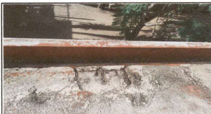
Imagen de grietas donde se filtra agua.
