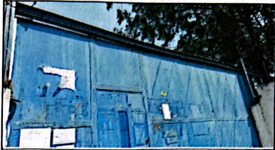
Foto 2: EL PUENTE QUE CARGA AL PORTÓN ESTA VENCIDO NECESITA REFUERZO Y CAMBIO DE RODOS
