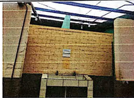
Foto 4: Área de baños sin techo.
