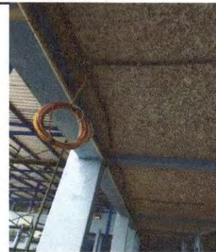
Foto 6: Cableado en pasillos de primer nivel.
