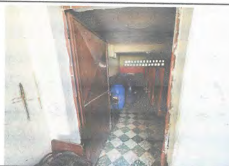
Foto 6: Baños Niñas, es necesario dar mantenimiento a puerta de ingreso
