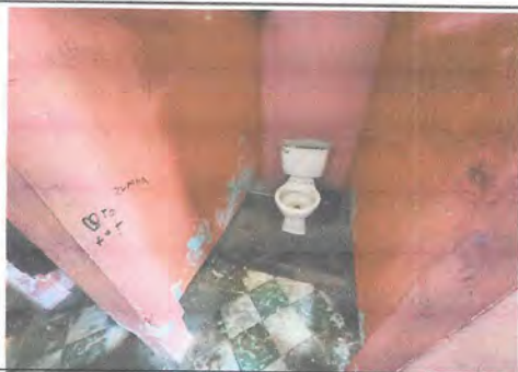
Foto 5: Baños Niñas, Sanitario sin Puerta, es necesario colocar nueva
