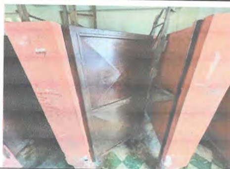
Foto 4: Baños Niñas, es necesario dar mantenimiento a puertas de sanitarios
