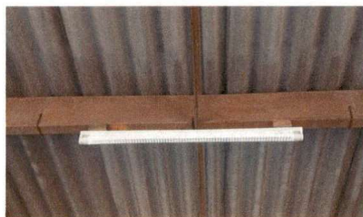
Foto 4: Sistema eléctrico: se quitarón los cables sin función electrica.
