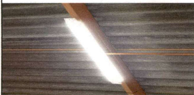
Foto 3: Sistema eléctrico: se sustituyo por lamparas led
