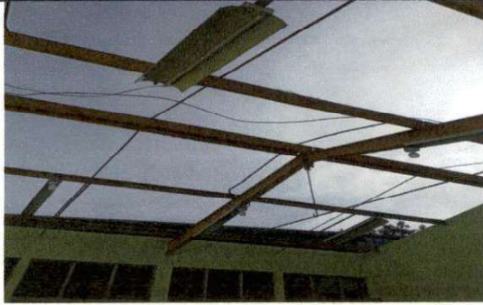
Foto 1: Aulas, El techo esta removido de su estructura
