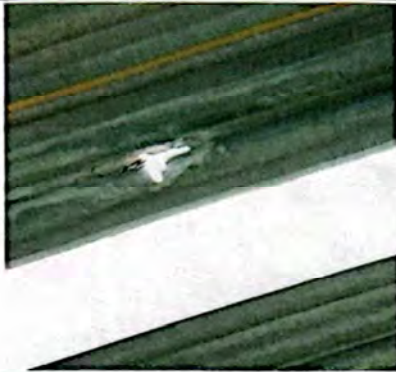
Foto 1: MÓDULO DE AULAS, EL TECHO TIENE AGUJEROS MUY GRANDES
