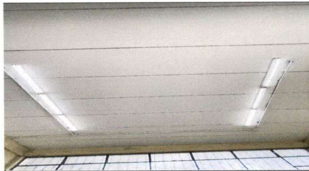
Foto 4: Techo resanado y pintado de la Cocina y bodega de Escuela Dario González
