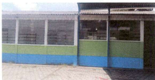
Foto 5: Pintura Interior en la pared que comunica el area de preprimaria con el area de primaria
