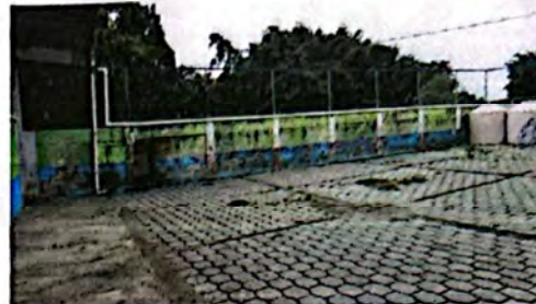
Foto 8: Pintura Interior de la pared que esta al tope de la escuelita de Preprimaria
