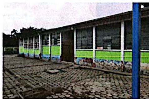
Foto 6: Pintura Interior en la pared que comunica el area de preprimaria con el area de primaria
