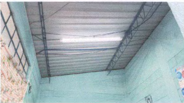
Foto 5: iluminación de cocina
