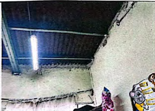
Foto 3: Se puede apreciar que los Mojinetes no se encuentran acabados, por lo que se deberá aprovechar al momento del cambio de techo para mejorar este punto.
