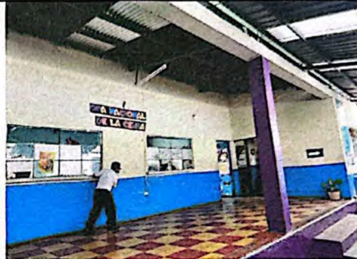
Foto 2: El techo de duralita también se encuentra en la parte del pasillo del Bloque A
