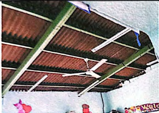
Foto 1: . Techo de duralita que deberá ser reemplazado, debido a las malas condiciones en las que se encuentra.
