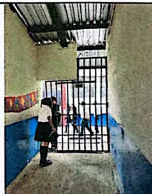
Foto 4: Puerta de barrotes actual que presenta daños por oxidación y se encuentra torcida por el uso.
