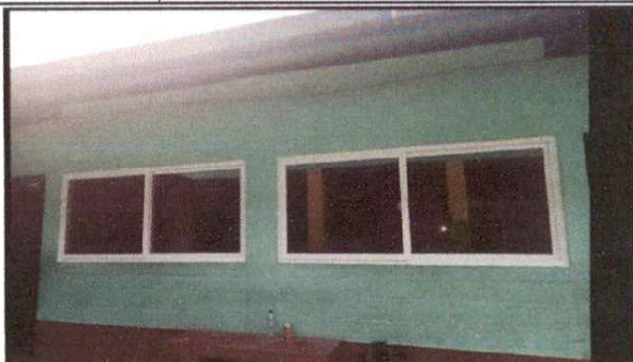
Foto 2: Ventanas del salon la cual se encuentran en mal estado por lo que seran cambiadas por Ventanas totalmente nuevas de PVC.
