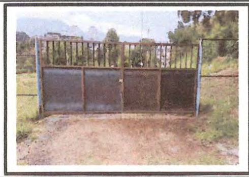
Foto 6: PORTÓN INSTALADO SIN PINTURA.
