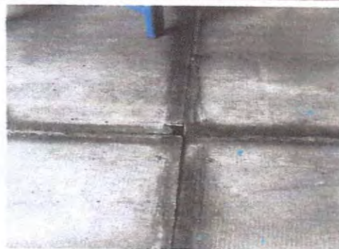
Foto 3: Duela o piso con rajaduras y grietas.
