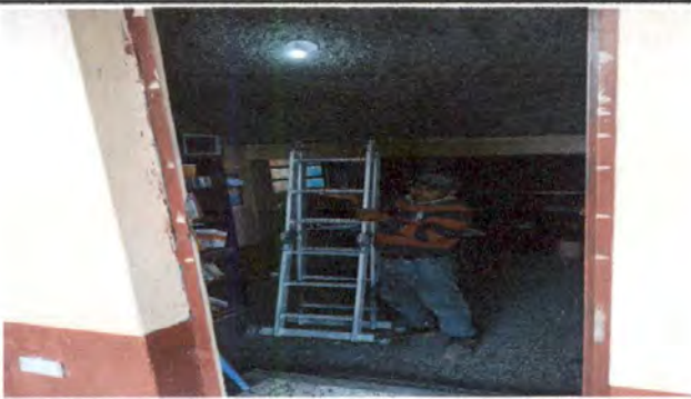
Foto 5: CAMBIO DE FOTOS EN DIRECCIÓN Y EN PASILLO
