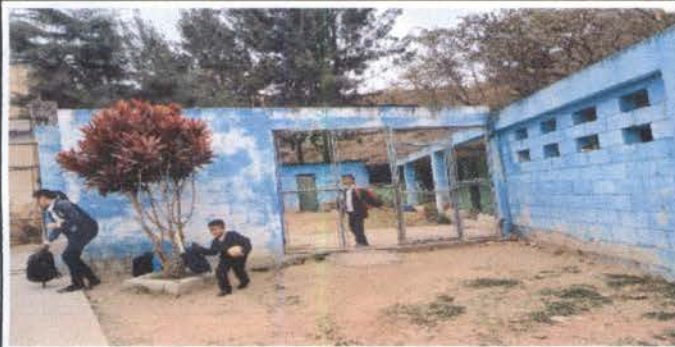
Foto 9: ESTO FALTA PINTAR PORQUE FALTA CONSTRUCCION
