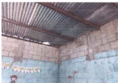
Foto 5: Salón 3, sin cable de luz eléctrica.
