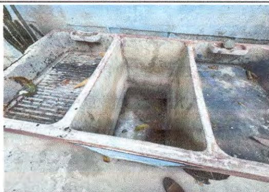
Foto 11: Se observa pila en mal estado
