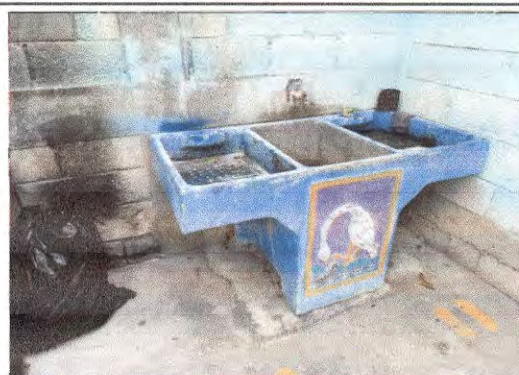
Foto 12: Se observa pila en mal estado
