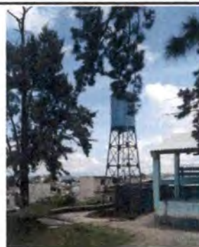
Foto 12: Mantenimiento de Cisterna
