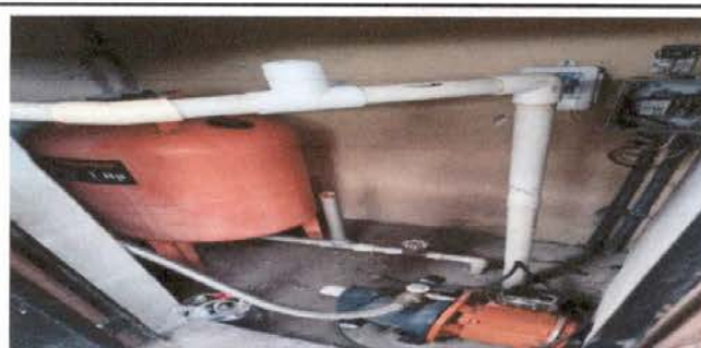
Foto 6: BOMBA DE AGUA
