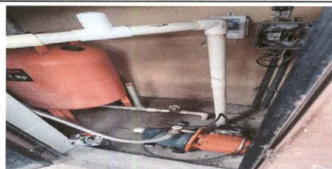
Foto 5: BOMBA DE AGUA
