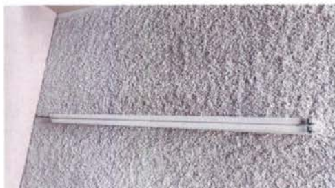
FOTO 5: Sustitución de lámparas tipo led
