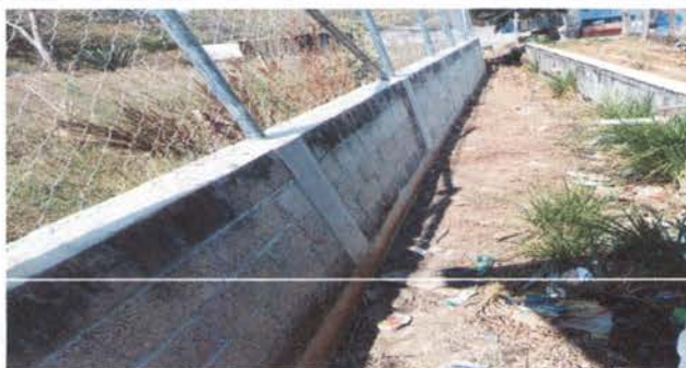
Foto 3: cuneta donde corre agua pluvial
