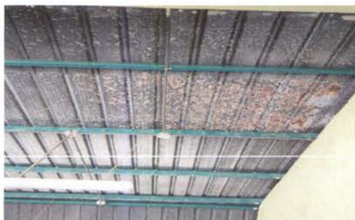
Foto 1: lámina en mal estado, se encuentra picada y en invierno se cuele el agua de lluvia
