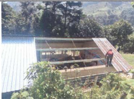
Foto 1: Cambio de techo que presenta deterioro.
