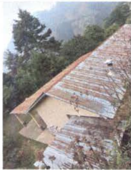
Foto 1: Cambio de techo que presenta deterioro.
