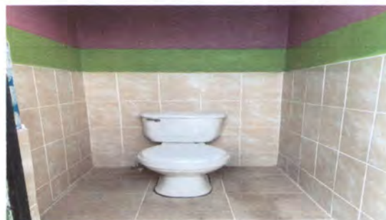
Foto 6: Instalación de sanitaria del establecimiento
