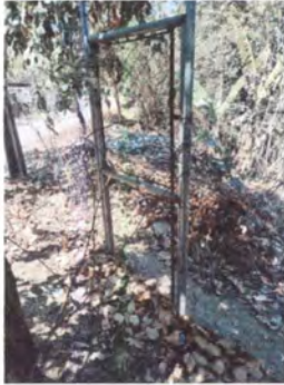
Foto 1: Vista de la puerta que se encuentra en la parte de atrás de la escuela se observa que necesita cambio ya que la seguridad es limitante.
