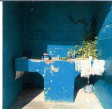
Foto 2: Sustrucción de pila en mal estado.
