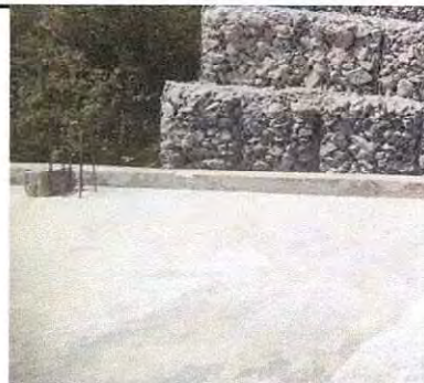
Foto 6: Falta del impermeabilización de losa
