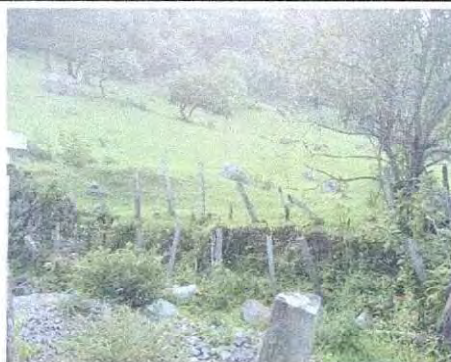
Foto 4: Falta de cerco o muro perimetral
