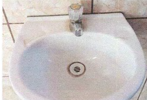
Foto 2: Sustrucción de lavamanos servicio sanitario de niñas.
