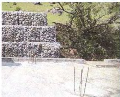
Foto 5: Falta del impermeabilización de losa
